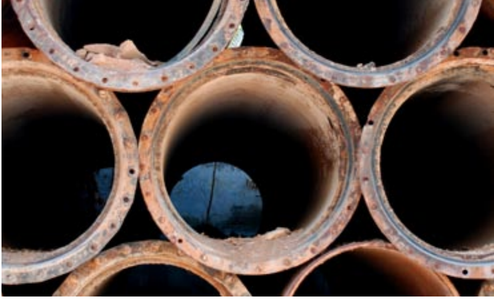
أنابيب المياه الصدئة.
